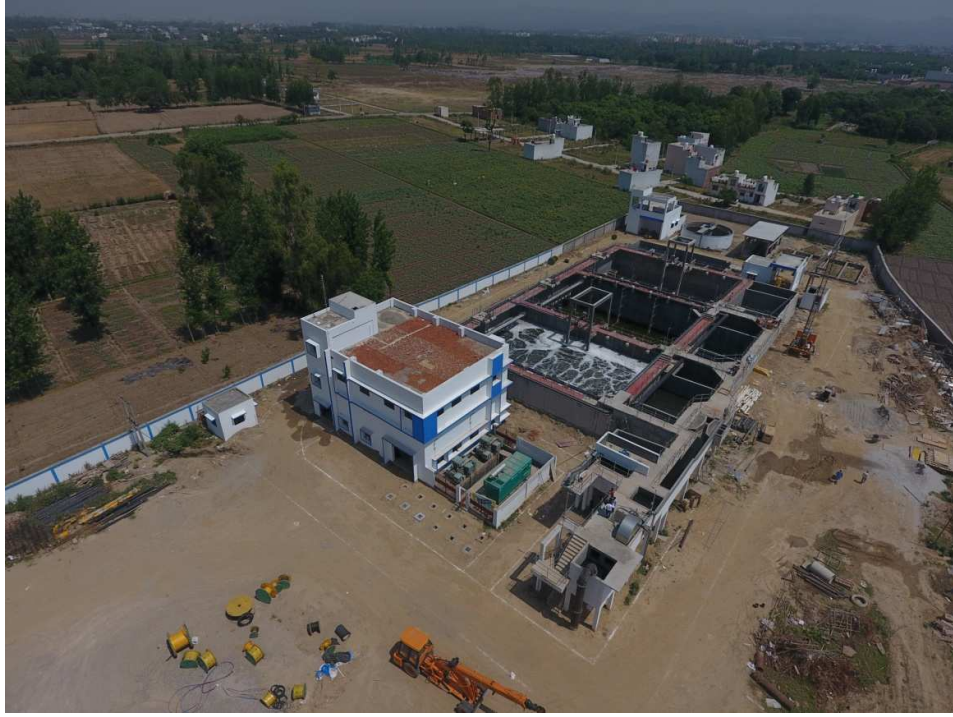
14 MLD STP, Sarai
