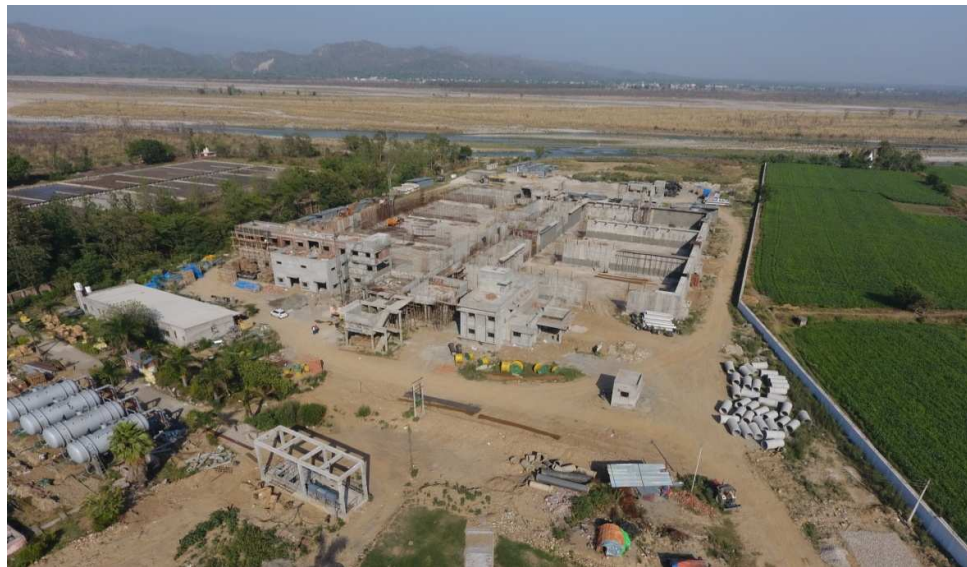
68 MLD STP, Jagjeetpur
